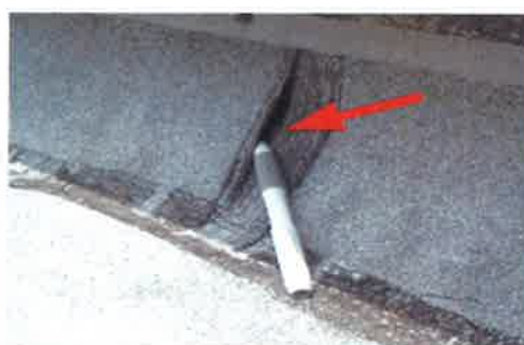
立上防水材のふくれ及び破断
