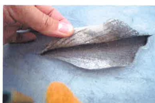
防水材の亀裂
