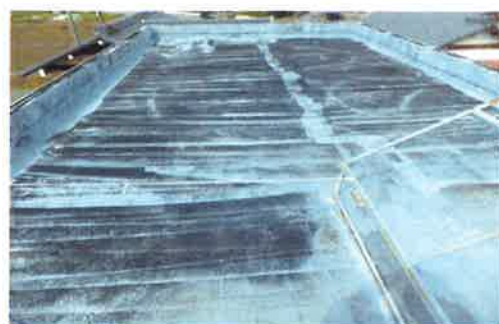
シート防水保護材の劣化
