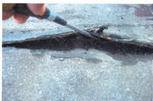
防水材の亀裂
