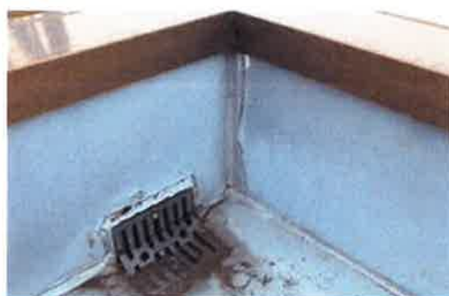
シート防水入隅の破断
