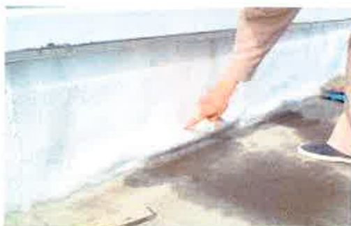
シート防水立上り防水材のたるみ
