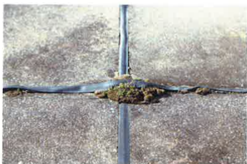
伸縮目地の異常
