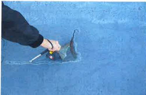
クラックによるめくれ
