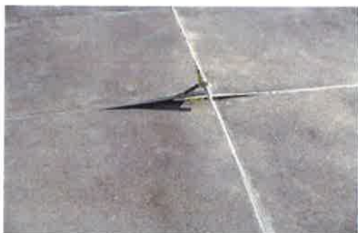
伸縮目地の異常
