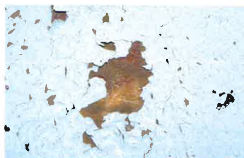
塗膜材の劣化
