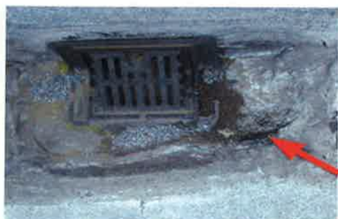
ドレン廻りコーティングの劣化
