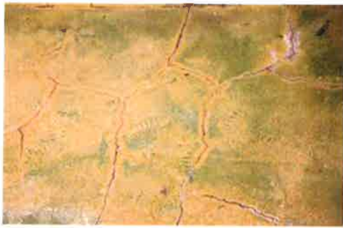
床面のひび割れ
