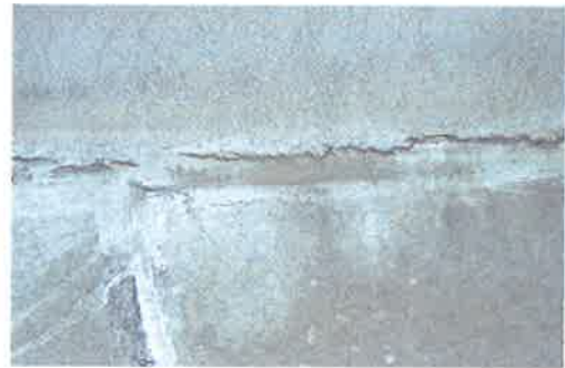
入隅部の亀裂
