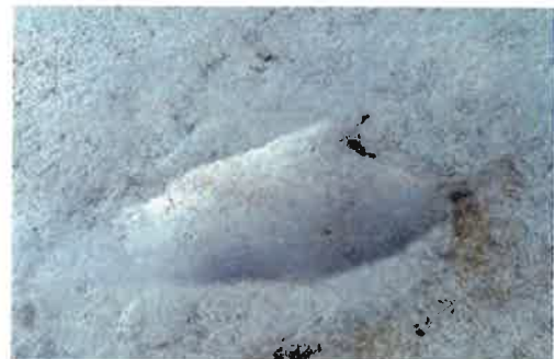
浮き及びふくれ
