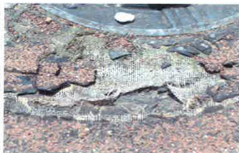
ドレン廻りの防水材劣化
