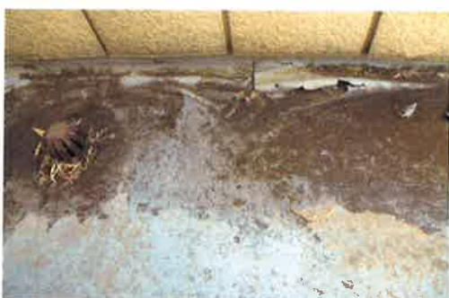
入隅部分の劣化
